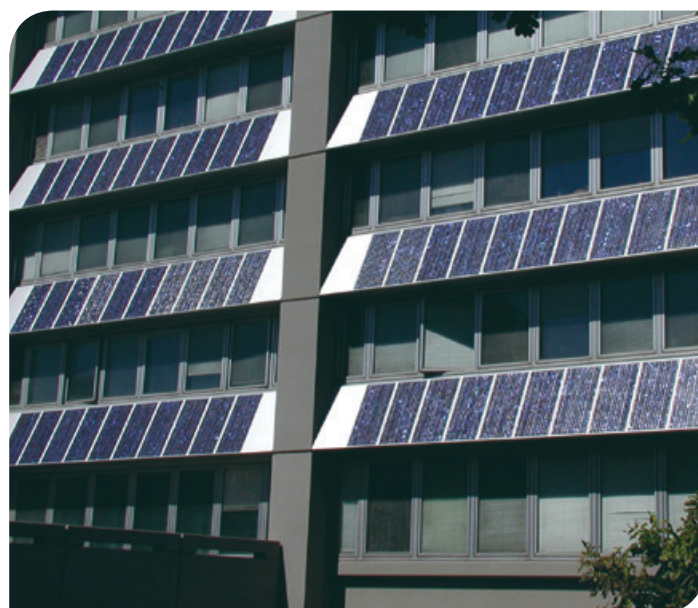
Figura 3 Sistema fotovoltaico integrado numa fachada de um edifício em Genebra. Fonte: https://www.flickr.com/photos/us-mission/3881123643
